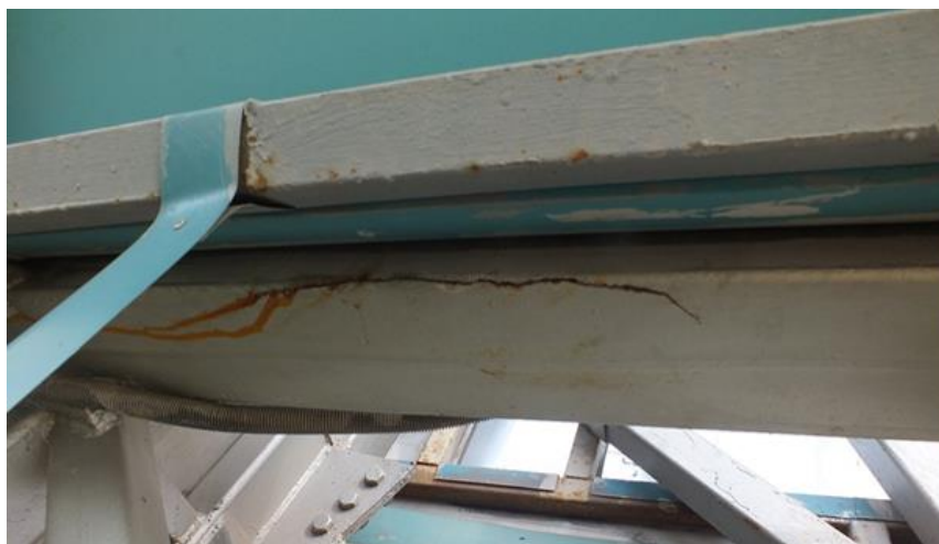
а – несоответствие угла наклона стержней решетки в узлах требованиям [2, 3]; б – трещины в поясах ферм из-за некачественных сварных швов Рисунок 1 – Ошибки при конструировании ферм из ГСП
